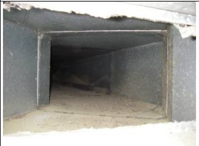
Kuva 10. Vuodeosastosiiven iv-koneen ulkoilmakammiossa pölykerrostumaa pohjalla ja rihmastoa seinämissä.
