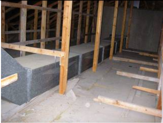
Kuva 7. Ilmanvaihtokoneen ulkoilmakanava päässyt taipumaan kannakkeiden vähäisyyden vuoksi
