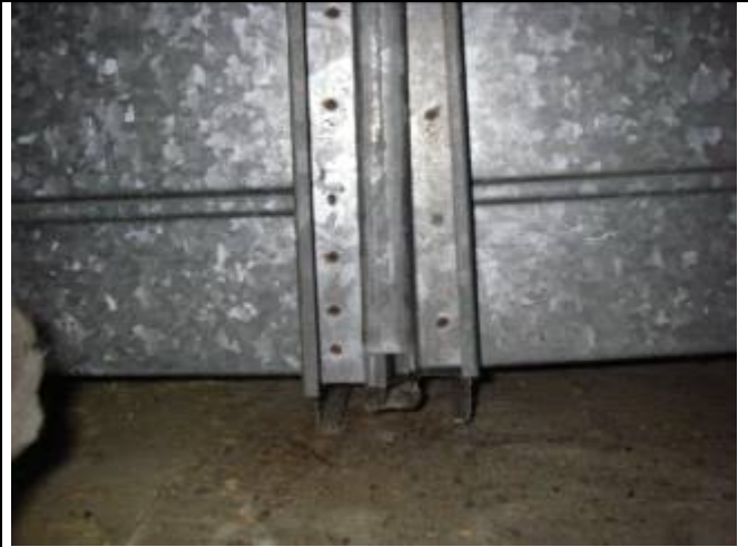
Kuva 8. Ulkoilmakanavan liitoskohdasta on valunut vettä kanavan sisästä (mm. lumen sulamisvesiä) yläpohjan lämmöneristeiden päälle
