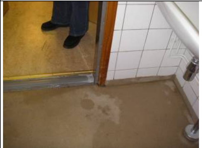
Kuva 4. Pesuhuoneen kynnysrakenteessa epätiiveyttä
