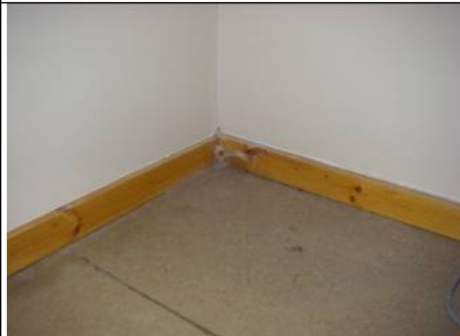
Kuva 12. Yhdyskäytävän varastohuoneen nurkassa homekasvustoa
