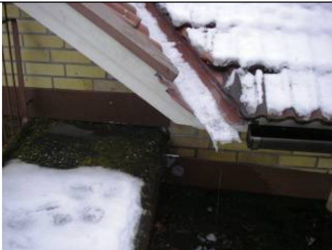
Kuva 11. Räystäskourun pää ei yllä jiirin alapuolelle
