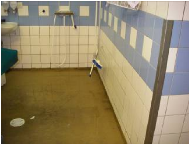
Kuva 3. Pesuhuoneen 124 lattiapinnnoitteessa värimuutoksia ja hiushalkeamia
