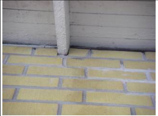
Kuva 2. Aluskate päätytty ulkoverhouslinjan tasalle. Aluskatteen päältä valunut vesi on kastellut tiiliseinää.
