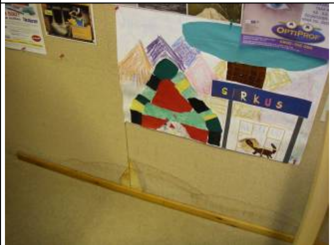
Kuva 6. Huoneen 170 seinälevyssä vanha kosteusvauriojälki
