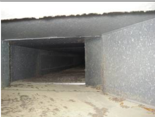
Kuva 9. Terveyskeskussiiven iv-koneen ulkoilmakammiossa pölykerrostuma pohjalla
