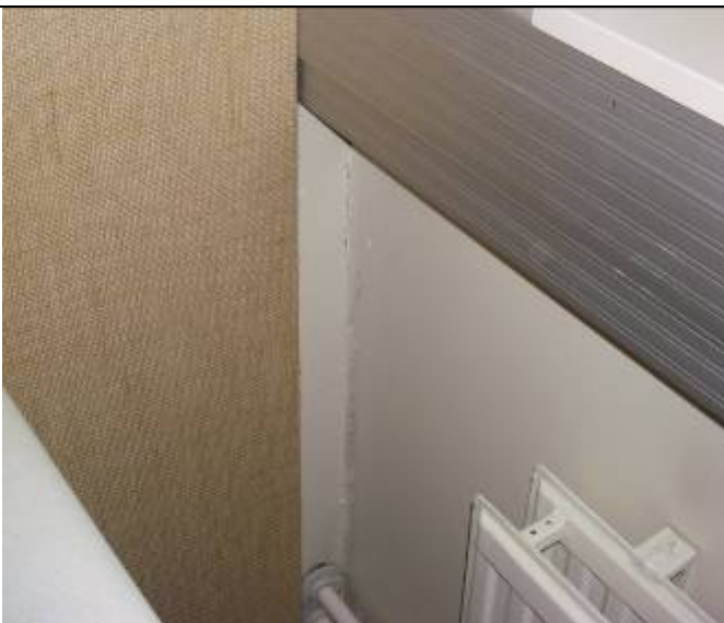
Kuva 5. Ulkoseinän ja pilarin liittymässä halkeama
